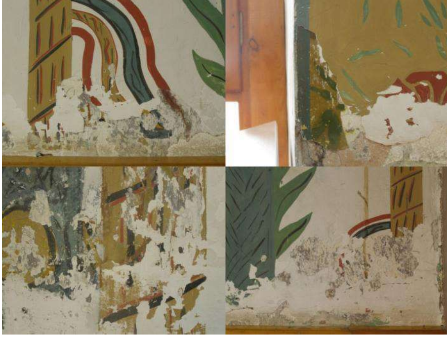
Resim 15. Resim Yüzeylerindeki Boya Dökülmesi Örnekleri (E. Yetiş, 2015).
