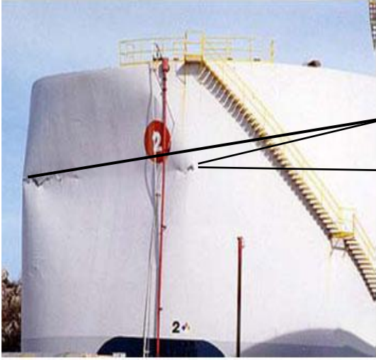
Şekil 11. Depremde oluşmuş çöküntü
