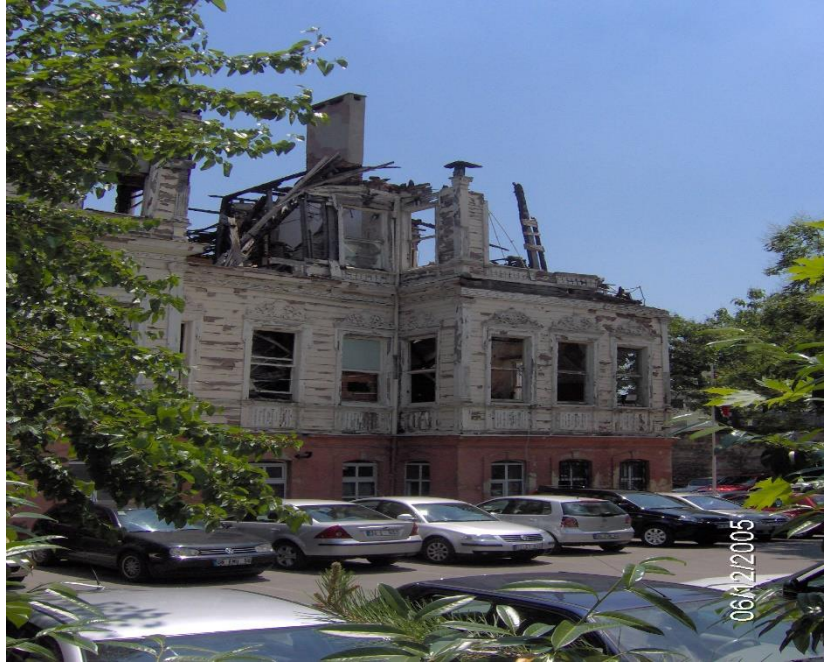
Resim 6. Yangından Sonra Çatının Durumu.
