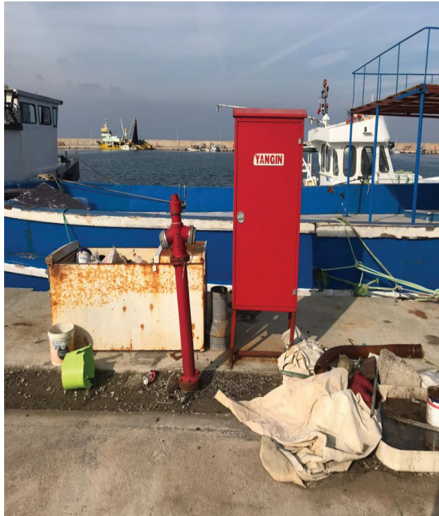
Resim 11. Yangın söndürme sistemleri, ve yangın dolabı
