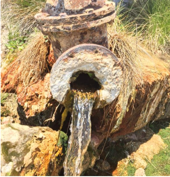
Şekil 9. 8 nolu kuyu başından gözlenen kabuklaşma.
