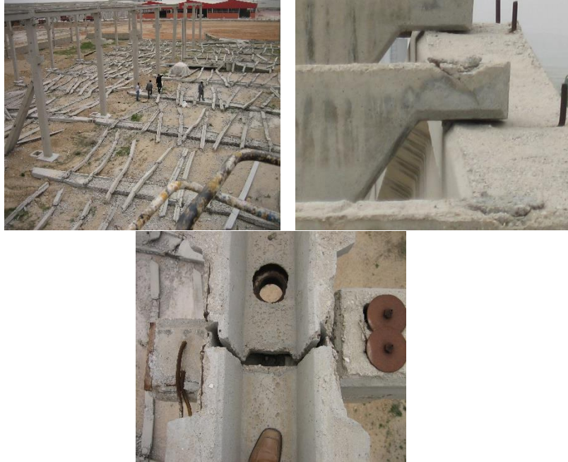
Şekil 12. Kirişlerde oluşan kesme hasarları
