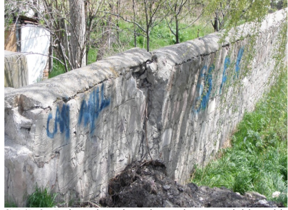
Şekil 3. Bahçe duvarlarında gözlenen çatlaklara bir örnek (An example of the cracks observed on the garden walls)
