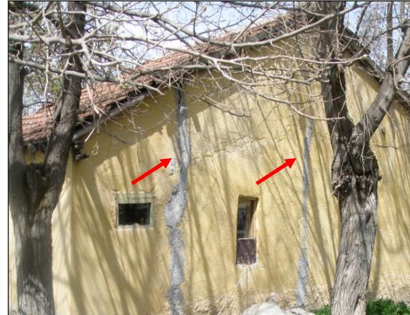
Şekil 4. Yapılarda zemindeki şişmeye bağlı oluşması muhtemel hasarlara bir örnek (An example of the damage on the buildings due probably to swelling of the clay)
