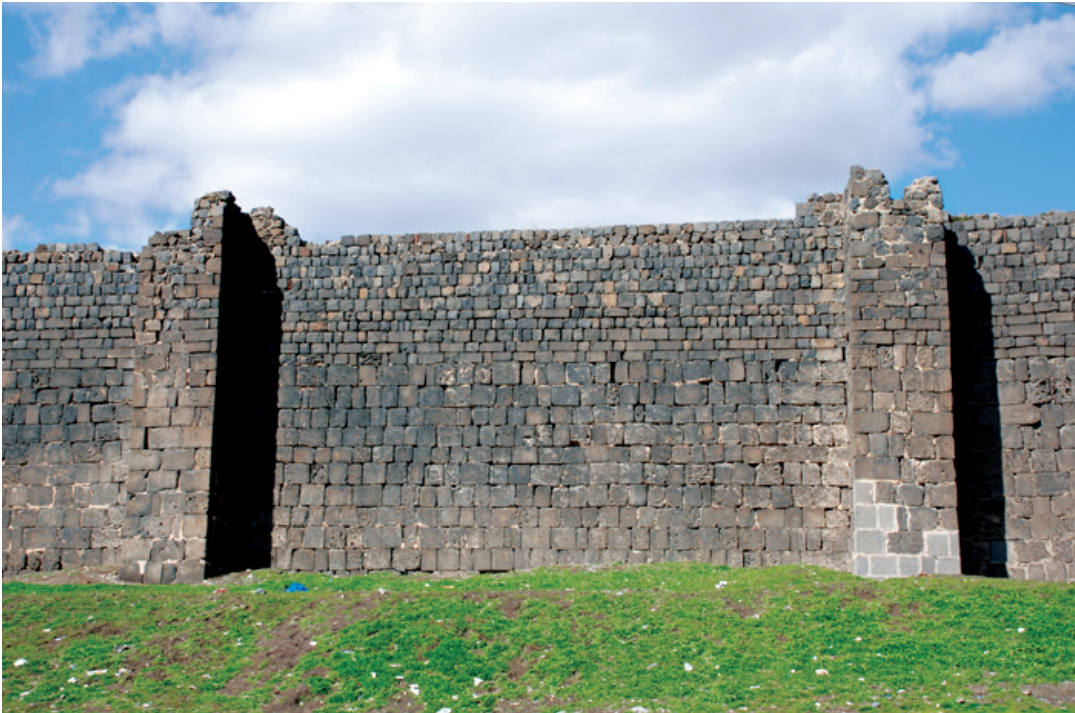
Şekil 11. Sur duvarları üzerindeki destek duvarlar - (54-55 nolu burçlar arası).
