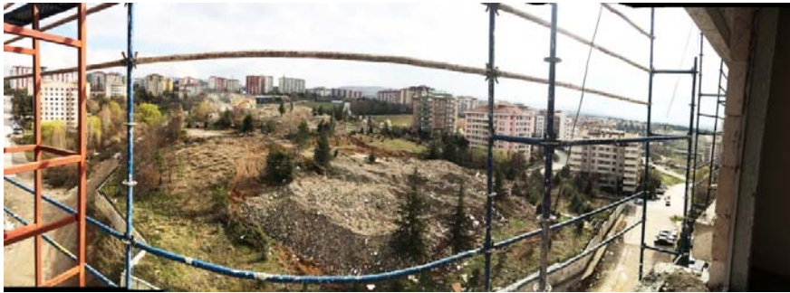
Şekil 3. Yıkım sonrası sahada biriken atıklar (Construction waste accumulated on the plot after demolition)
