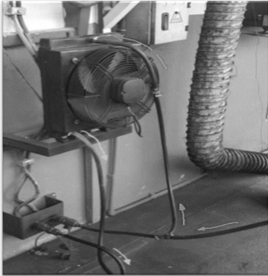
Şekil 1. Yakıt giriş sıcaklığının değiştirilebilmesi için oluşturulan yakıt soğutma sistemi
